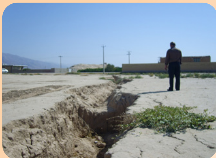
► شکاف ناشی از فرونشست در منطقه کوه سفید داراب
